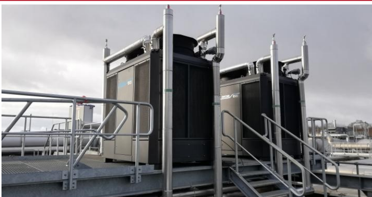
Im BASF-Werk wird nun mithilfe der Technik von Orcan Energy aus Abwärme Strom erzeugt. (Foto: Orcan Energy)
